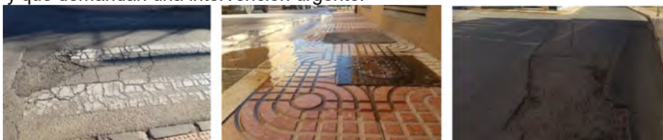
Imágenes de agrietamientos en superficie producidos por fatiga, deficiencias en infraestructuras e itinerarios peatonales inaccesibles.
